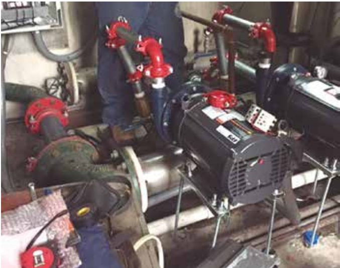
Cambios de bombas
