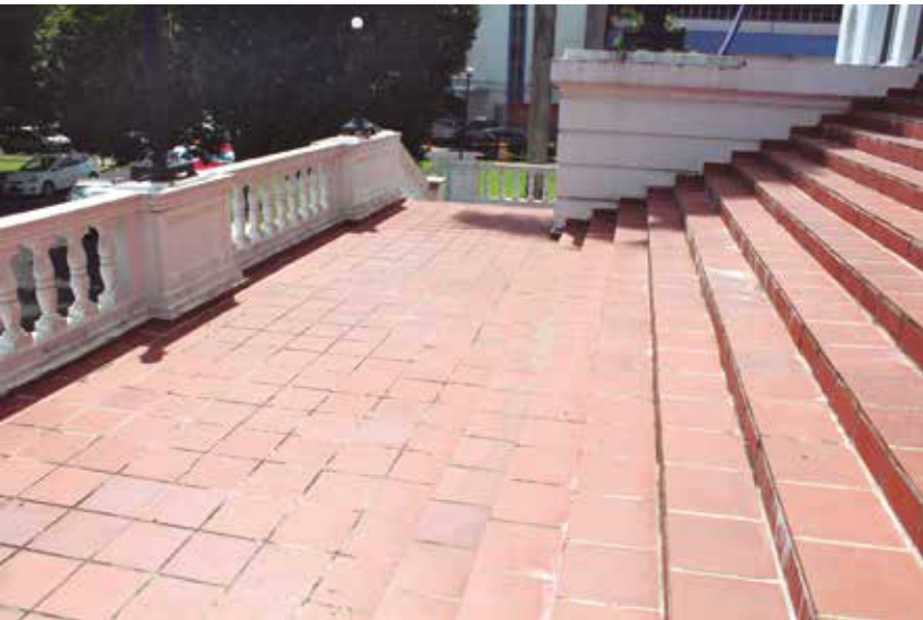
Remoción y reemplazo de las baldosas de arcilla de la escalinata principal del edificio Elefante Blanco. Existía un deterioro del piso y filtraciones constantes de agua lluvia en las oficinas de Imagenología. Reparado a un costo de: B/. 34,383.00 balboas
